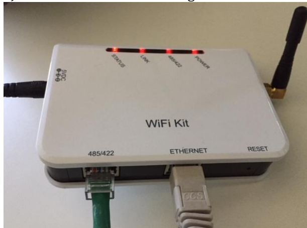
Figura 85 – Cavo Ethernet collegato al datalogger
