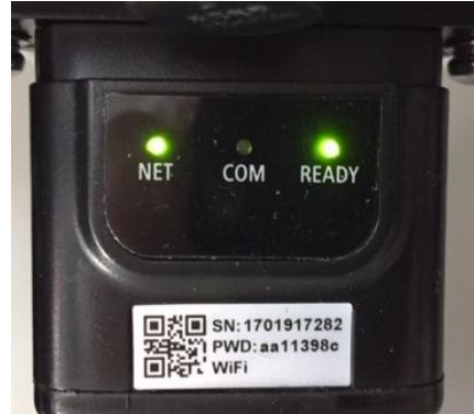
Figura 74 - Stato di comunicazione irregolare tra inverter e adattatore
