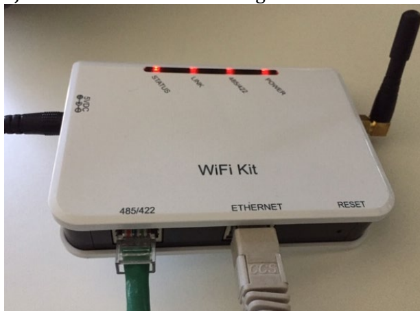
Figura 88 – Cavo Ethernet collegato al datalogger
