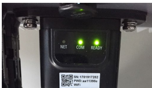
Figura 76 - Stato iniziale dei LED
