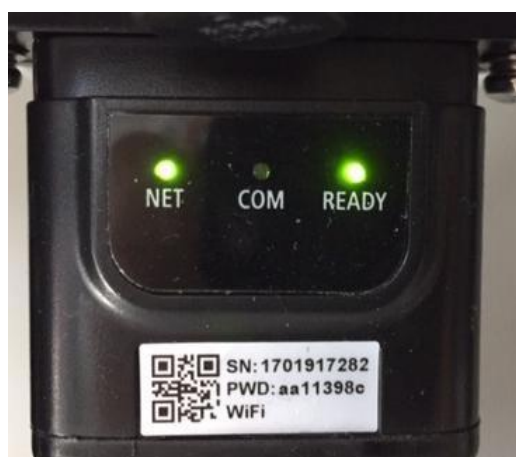
Figura 57 - Stato di comunicazione irregolare tra inverter e adattatore
