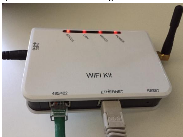
Figura 83 – Cavo Ethernet collegato al datalogger
