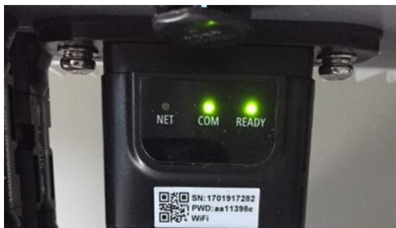
Figura 55 - Stato iniziale dei LED
